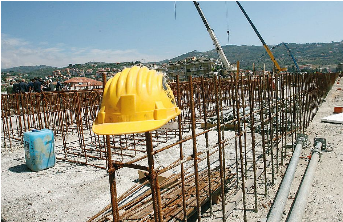
Foto simbolo di un cantiere abbandonato
